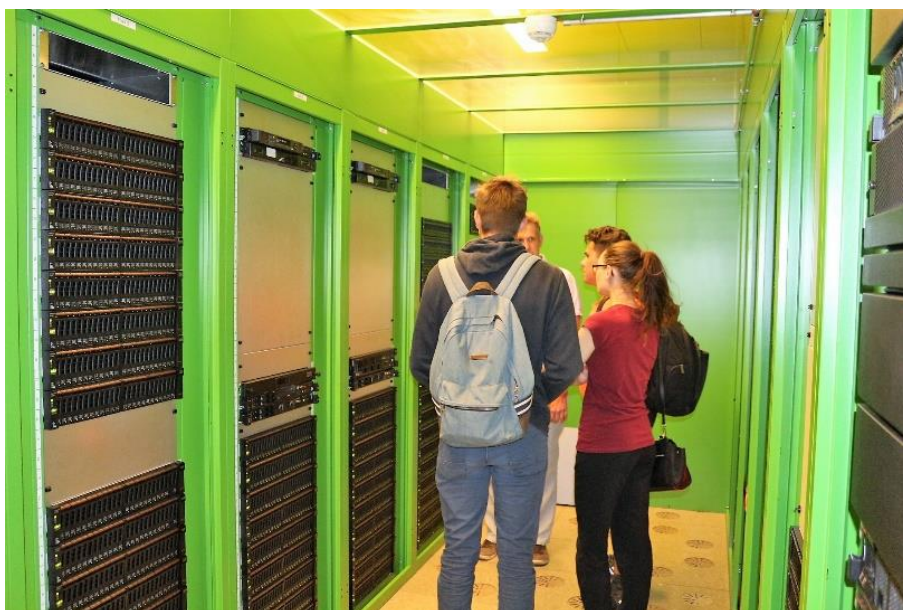
Abbildung 3: Gekühlte Server im Rechenzentrum
